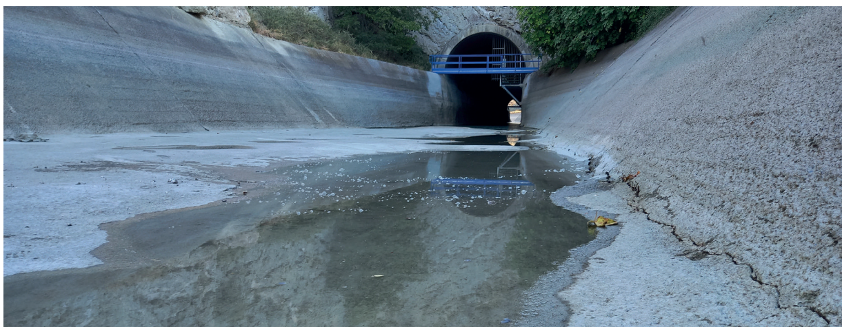
20 · Junio · 2023 Filtración en el pk 21 del canal principal
