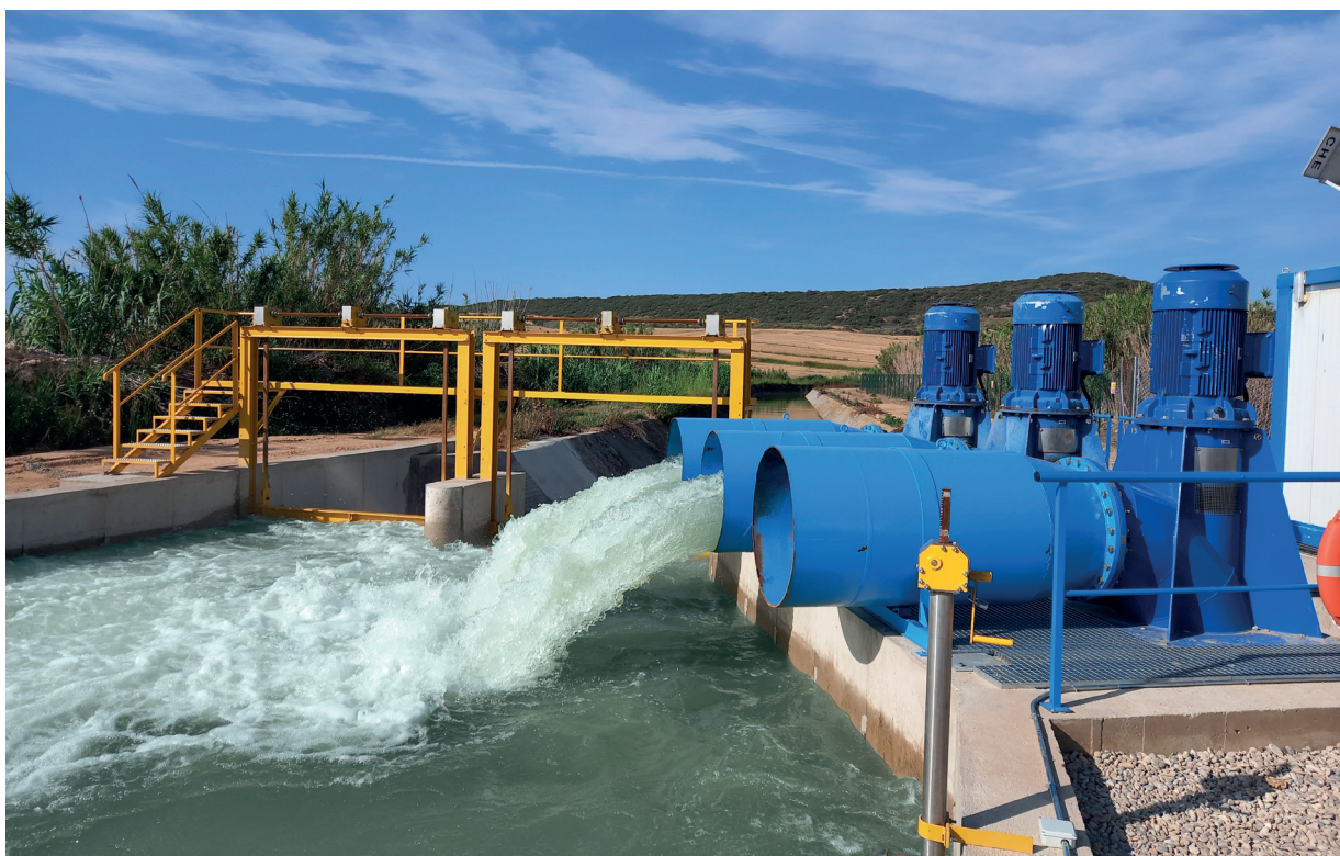
Estación de rebombeo hacia la cabecera de Esplús para dotaciones hasta 0,30 l/s/ha
