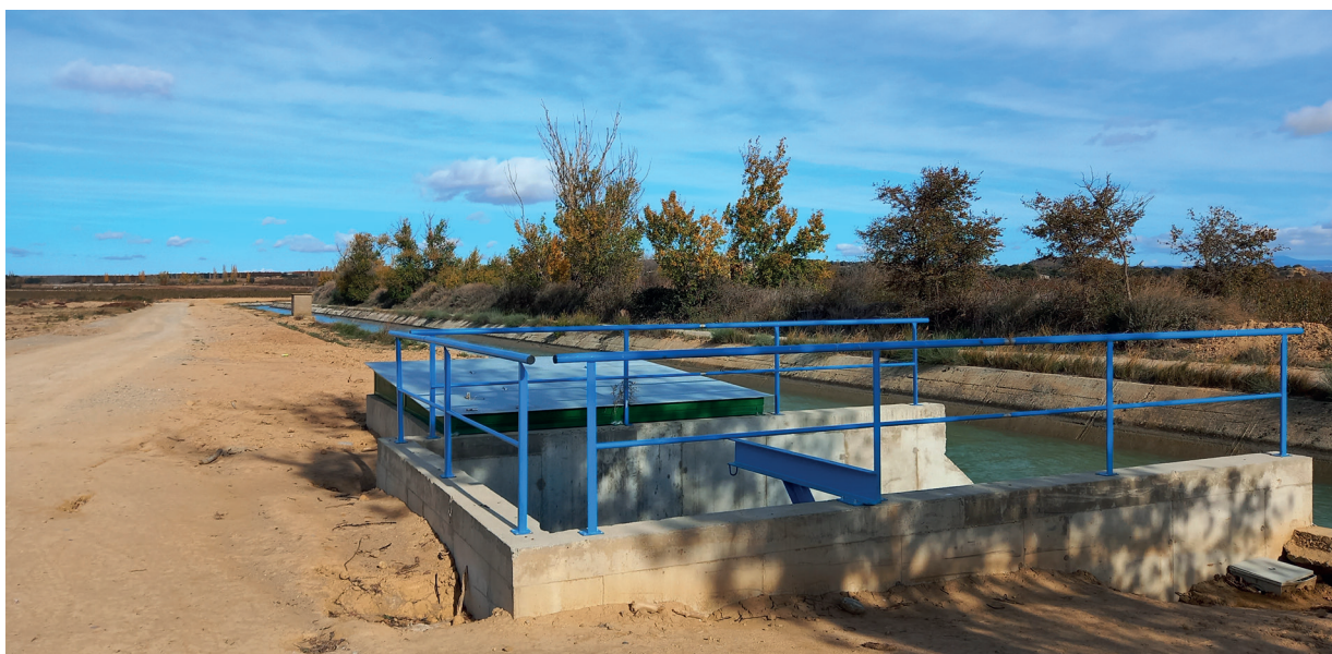
Alimentación a la acequia de Ripol y toma Z-11,3 para dotaciones bajas (0,20 l/s/ha).
